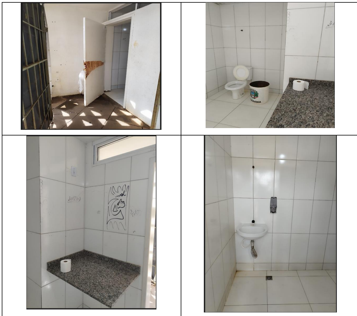
Figura 8 - Imagens do banheiro da Praça Santos Dumont em 2024
