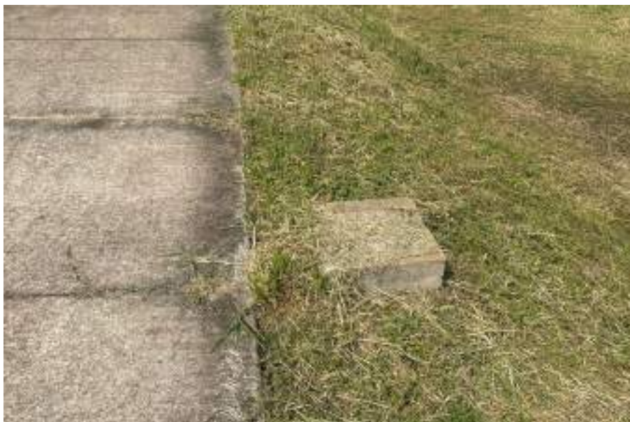
Figura 40 - Base de concreto sem poste de iluminação
