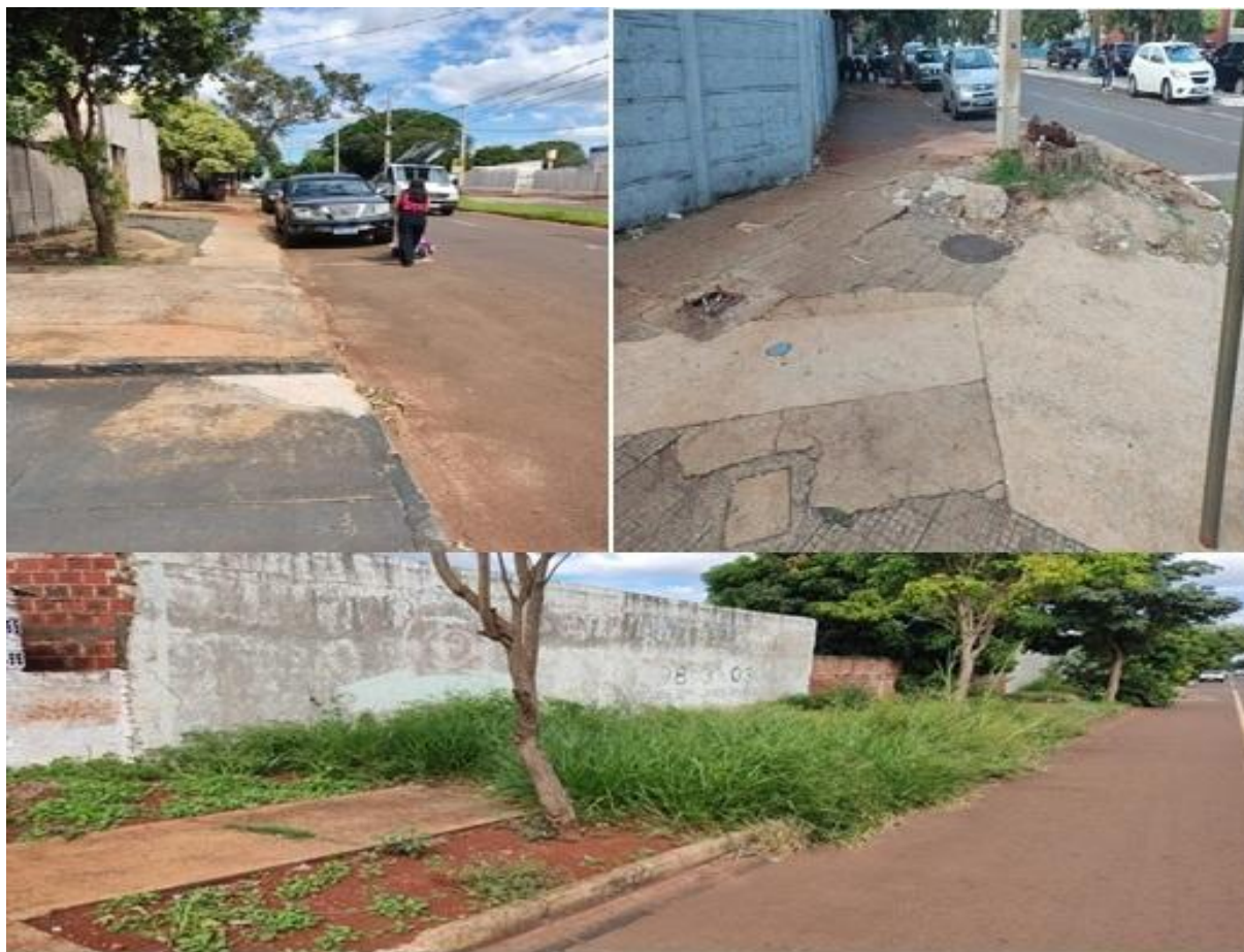
Figura 23 – Calçadas desniveladas e calçada com mato, dificultando ou impedindo a passagem de pedestres
