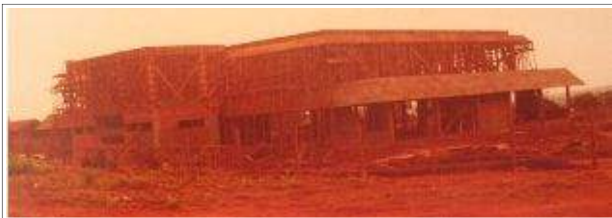
Figura 20: Vista parcial da construção da Prefeitura Municipal de Mamborê. Foto: cedida por Vilson Olipa.
