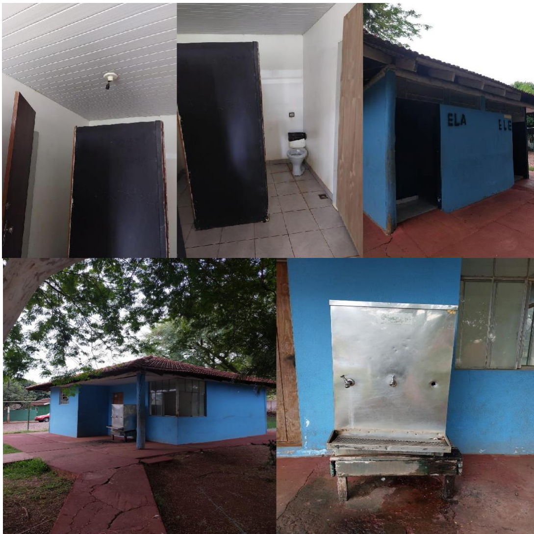
Figura 6 – Bebedouro e banheiros do Parque
